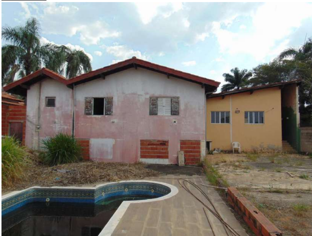
Figura 14 Fachada Externa com pintura compeltamente danificada
