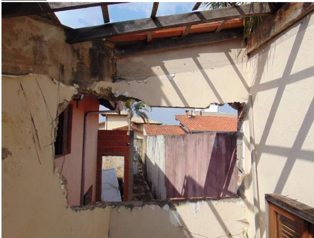
Figura 57 Janela sem esquadria e com parede quebrada, ausência de telhado e pintura completamente comprometida
