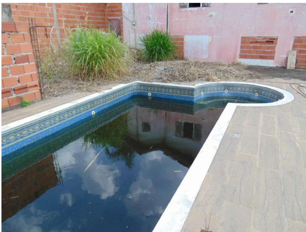
Figura 13 Identificação de Piscina abandonada, Condomínio se prontificou a tomar providencias com água parada
