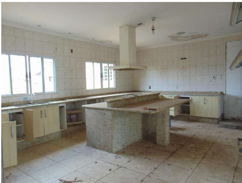
Figura 24 Identificação da cozinha com bancada inacabada, infiltrações no teto, sujeira e móveis danificados
