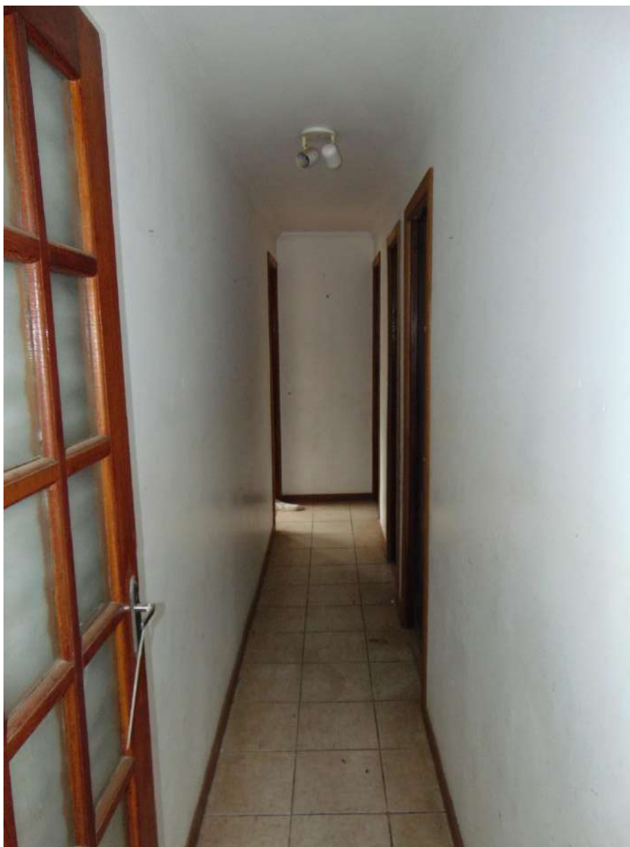
Figura 37 Identificação do corredor dos quartos, sujeira acumulada, e desgaste moderado da pintura
