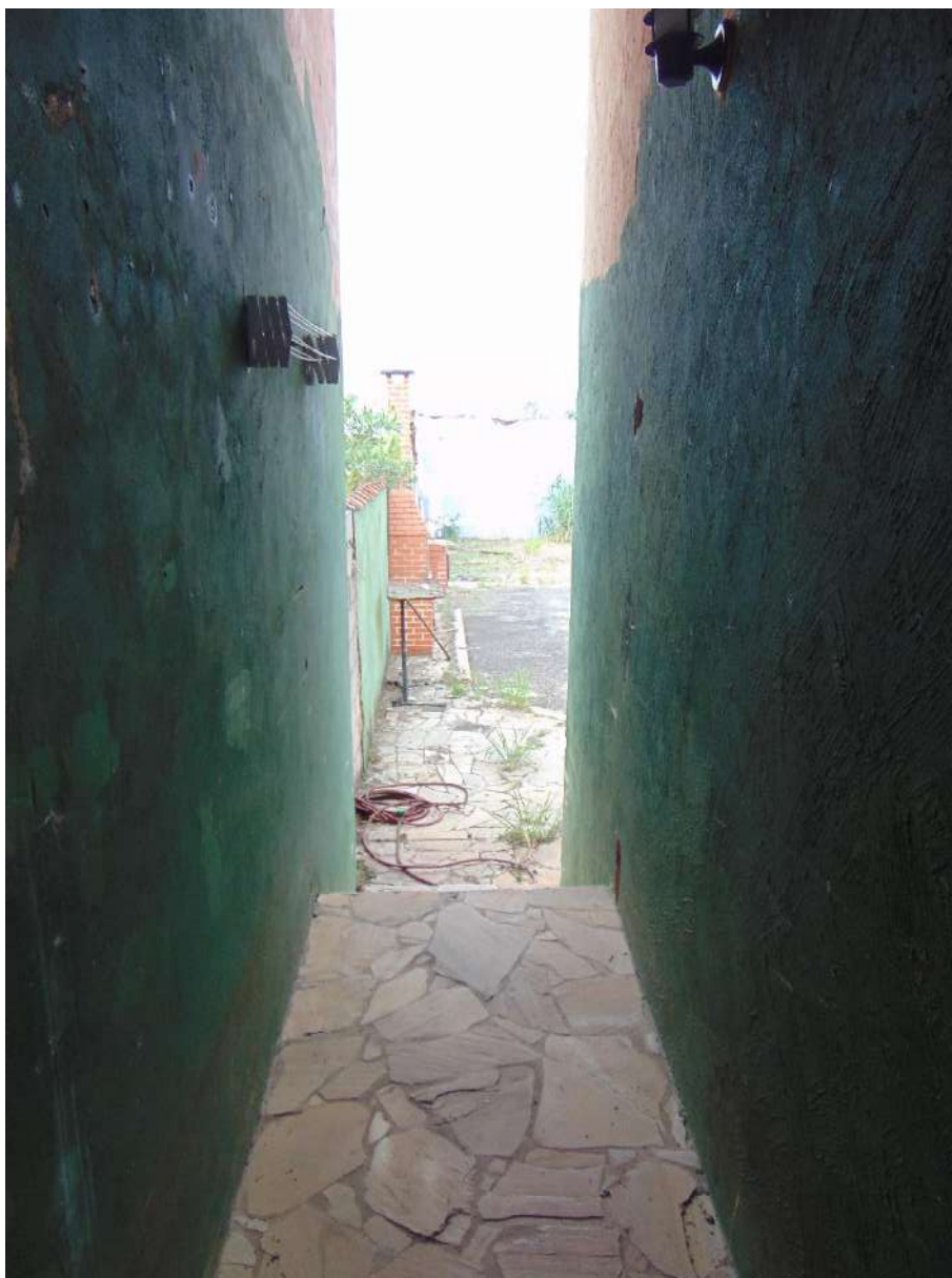
Figura 59 Corredor de acesso à área de lazer, pintura completamente desgastada
