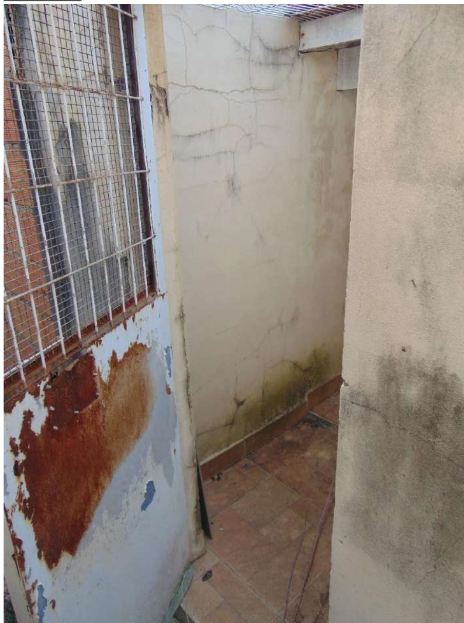
Figura 18 Canil, como paredes com umidade e pintura completamente desgastada, esquadrias enferrujadas
