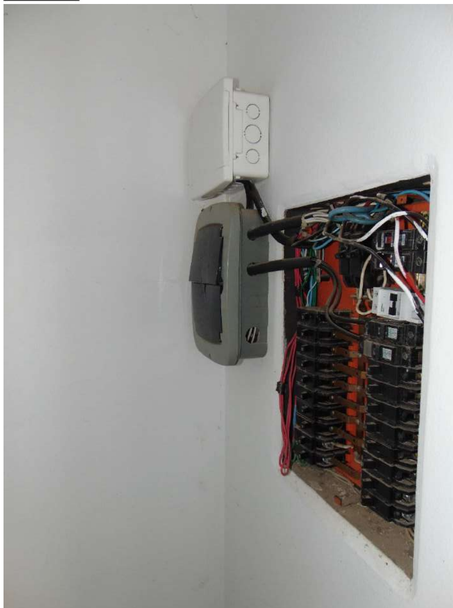
Figura 36 Painel de distribuição do imóvel
