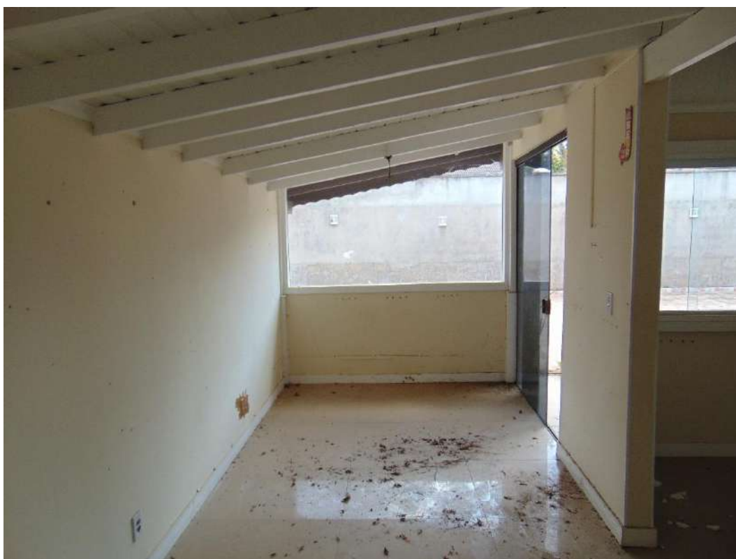
Figura 31 Área lateral da sala com acesso ao quintal frontal, com pintura com desgaste moderado.
