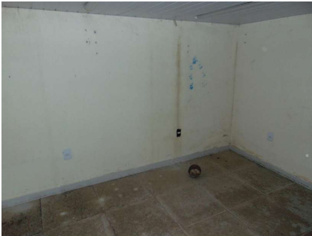
Figura 32 Identificação do closet da sala com acumulo de sujeira no piso, e pintura com grande desgaste, forro inacabado
