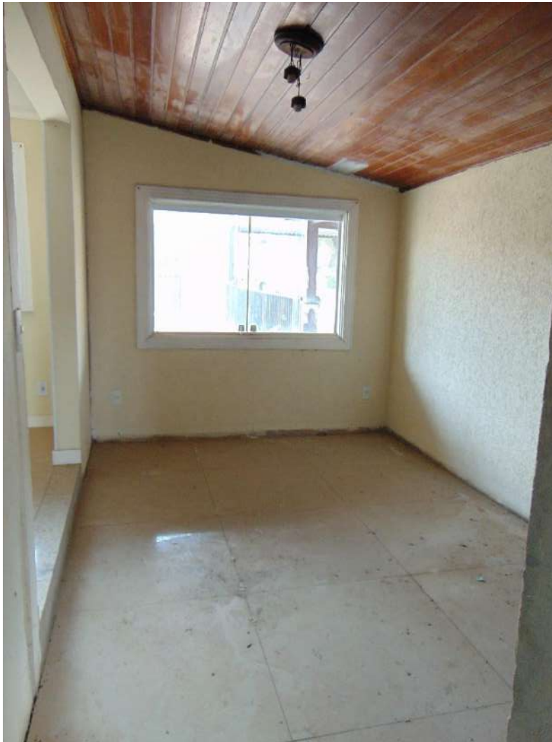
Figura 27 Identificação da área de lareira, forro danificado, pintura completamente desfastada
