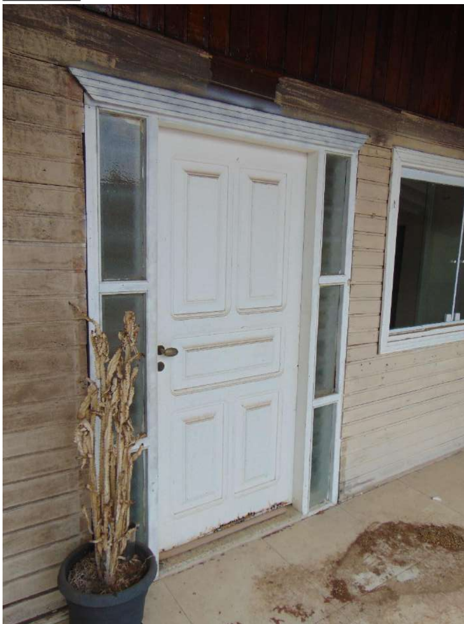
Figura 9 Porta de acesso principal, pintura e paredes de madeira totalmente avariadas
