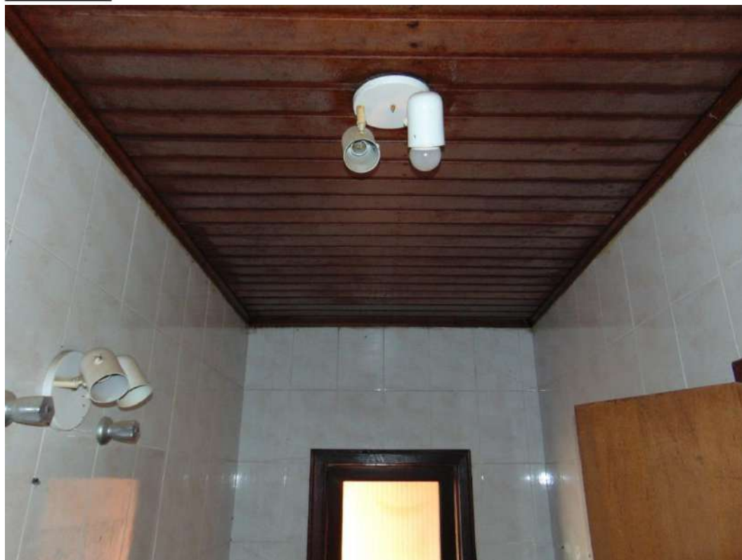
Figura 55 Detalhe Forro com pontos de umidade
