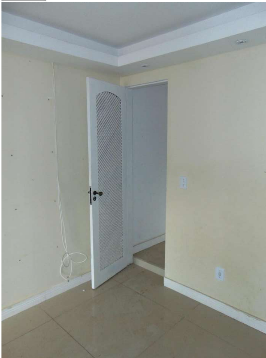
Figura 35 Acesso à sala elétrica
