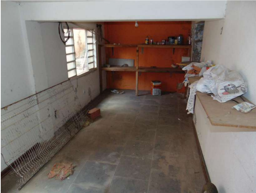
Figura 63 Oficina, pintura com desgaste acentuado, pontos de umidade, e instalações aparentes
