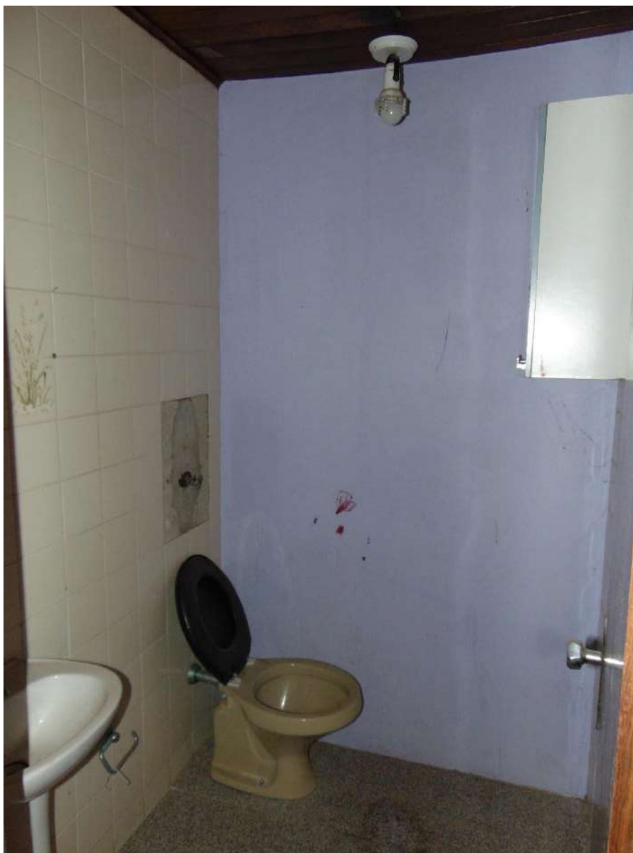
Figura 46 Identificação do banheiro social, ausencia de azulejo, forro e pintura danificadas
