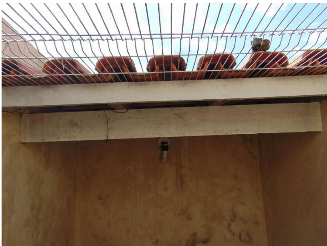
Figura 20 Detalhe do telhado, aofundo com pintura danificada
