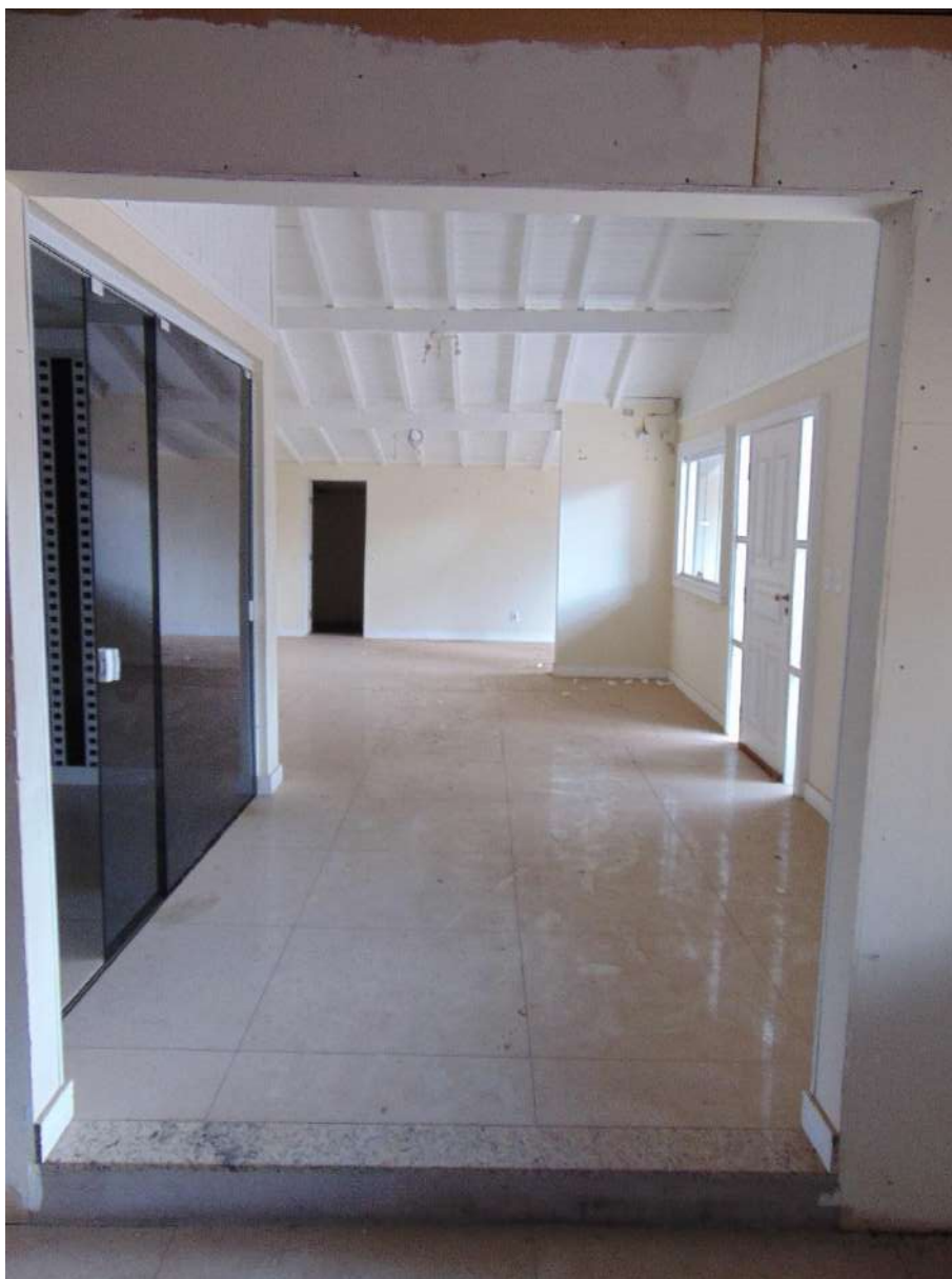
Figura 29 Identificação da Sala de Estar, forros desencaixados e pintura danificada,
