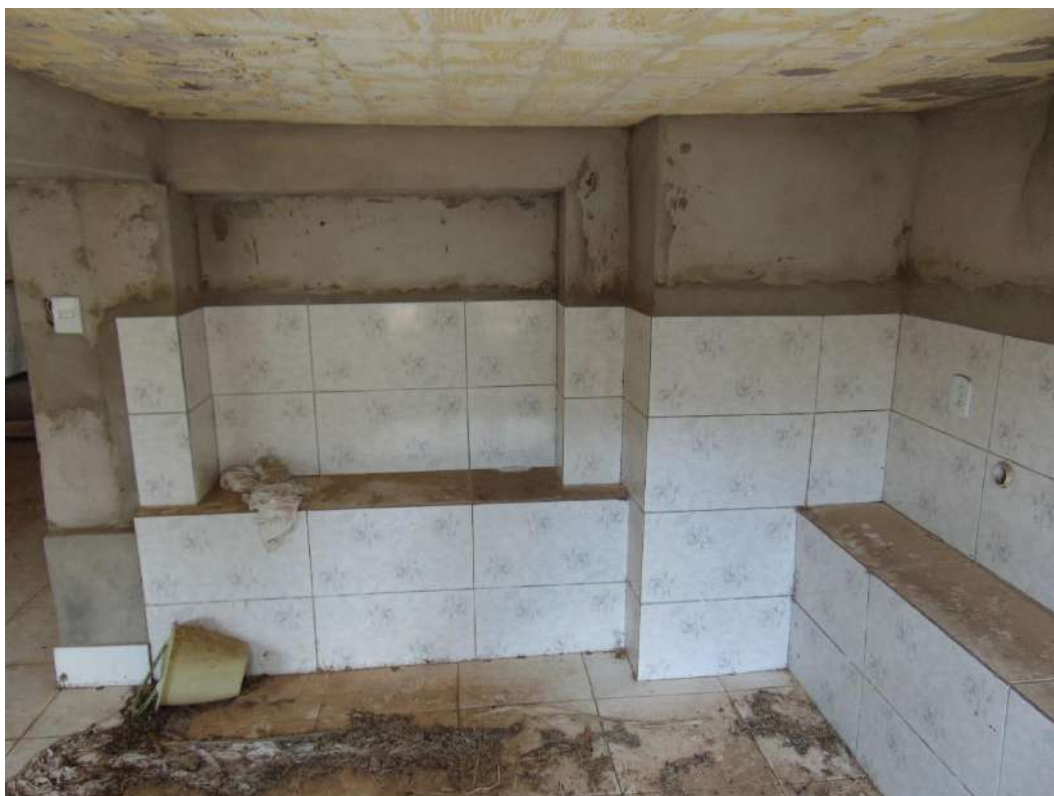
Figura 61 Identificação da sauna 1, com revestimento inacabado, e acumulo de sujeira
