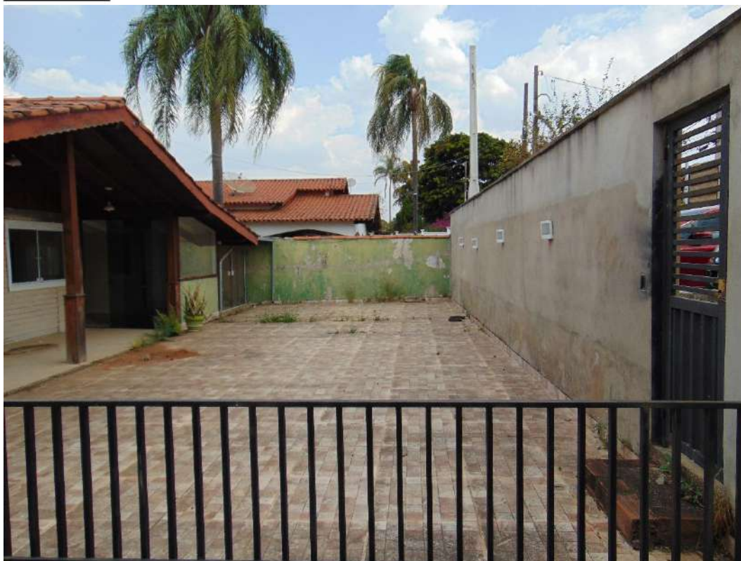
Figura 7 Quintal externo, pintura inacabada e totalmente avariada, pontos de infiltração e sinais de abandono
