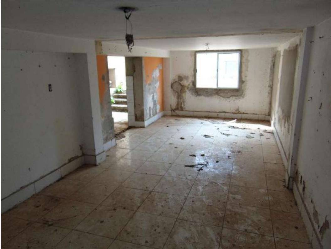
Figura 62 Salão, com pintura completamente avariada, e instalações aparentes, pontos de umidade identificados
