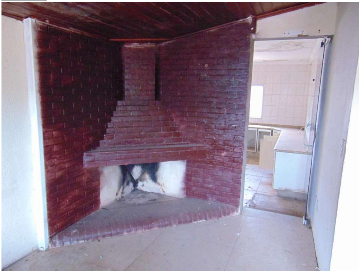
Figura 28 Identificação da lareira, com porta de acesso a cozinha à direita, pintura completamente desgastada
