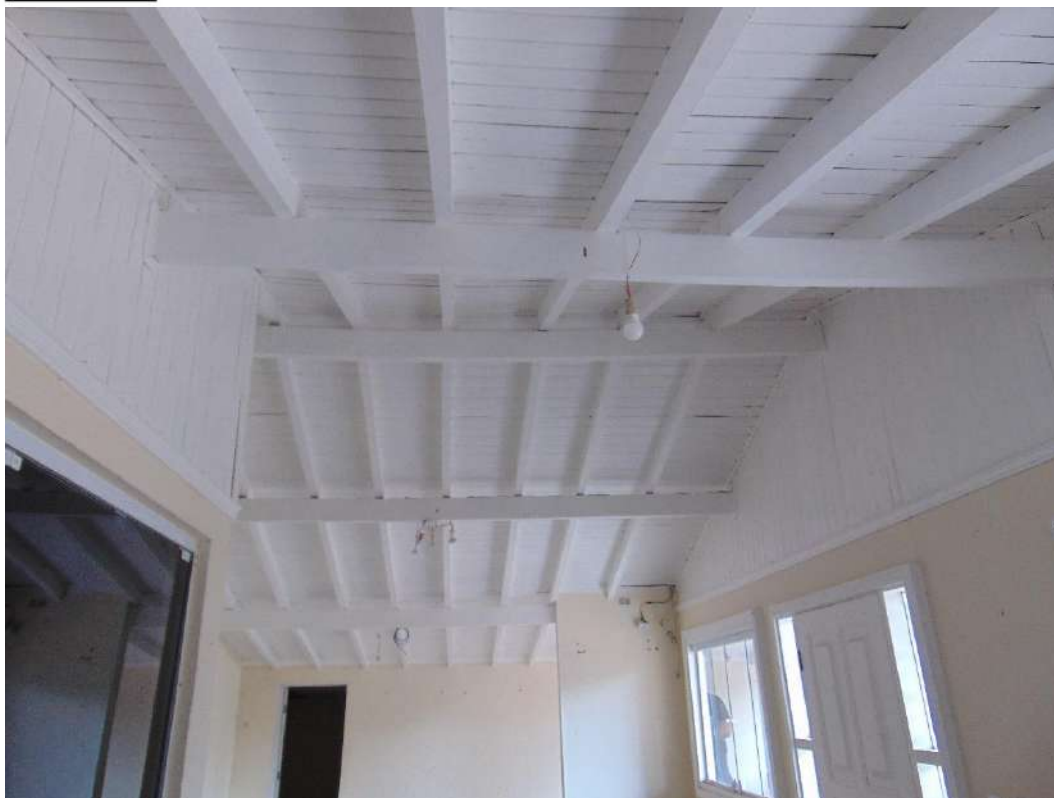
Figura 30 Detalhe do telhado com forros empenados e pintura levemente desgastada
