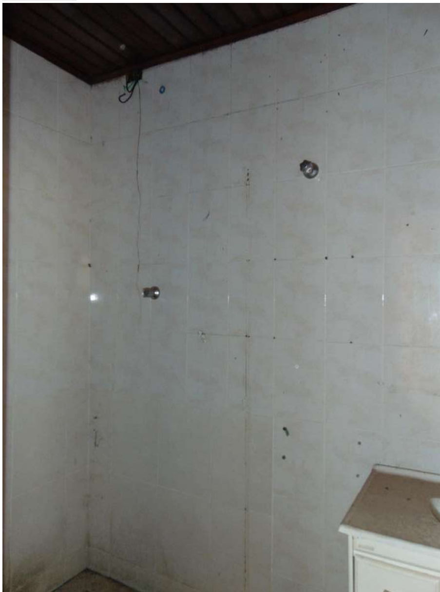
Figura 54 Fissuras no revestimento cerâmico
