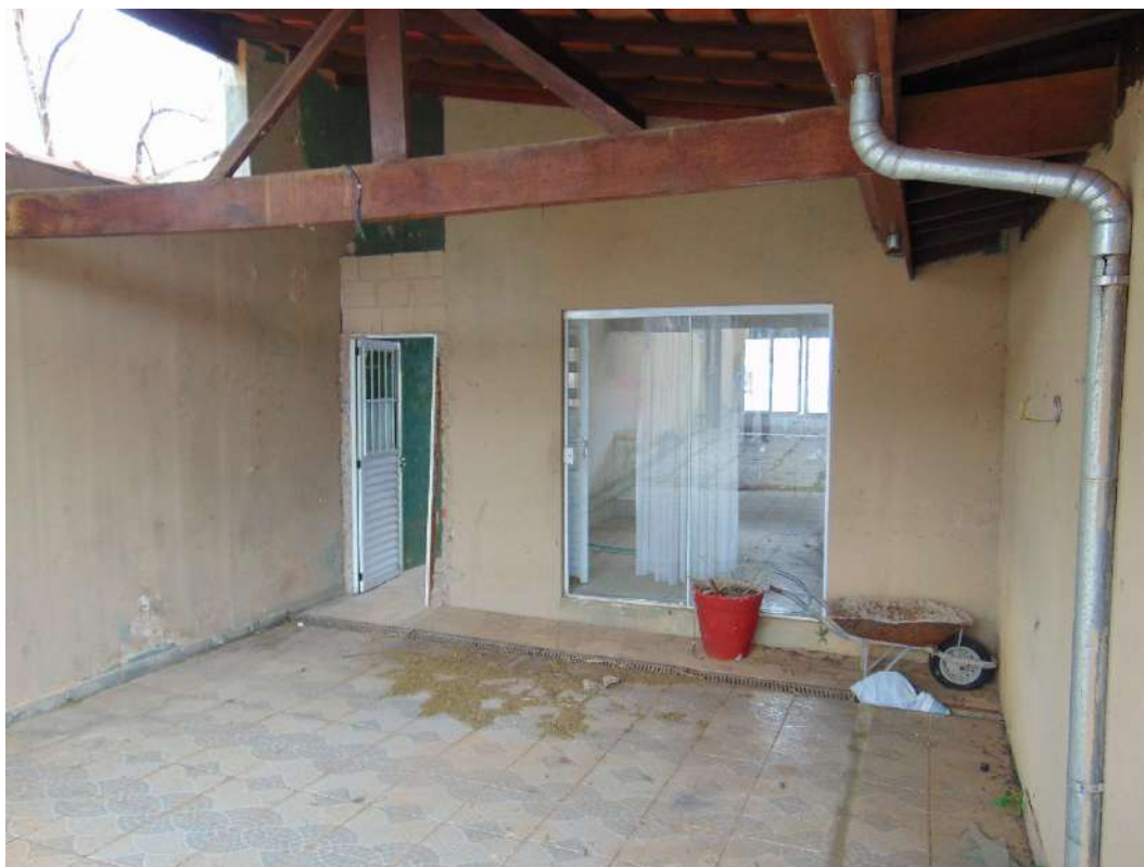
Figura 23 Interior da garagem, com avarias características de abandono
