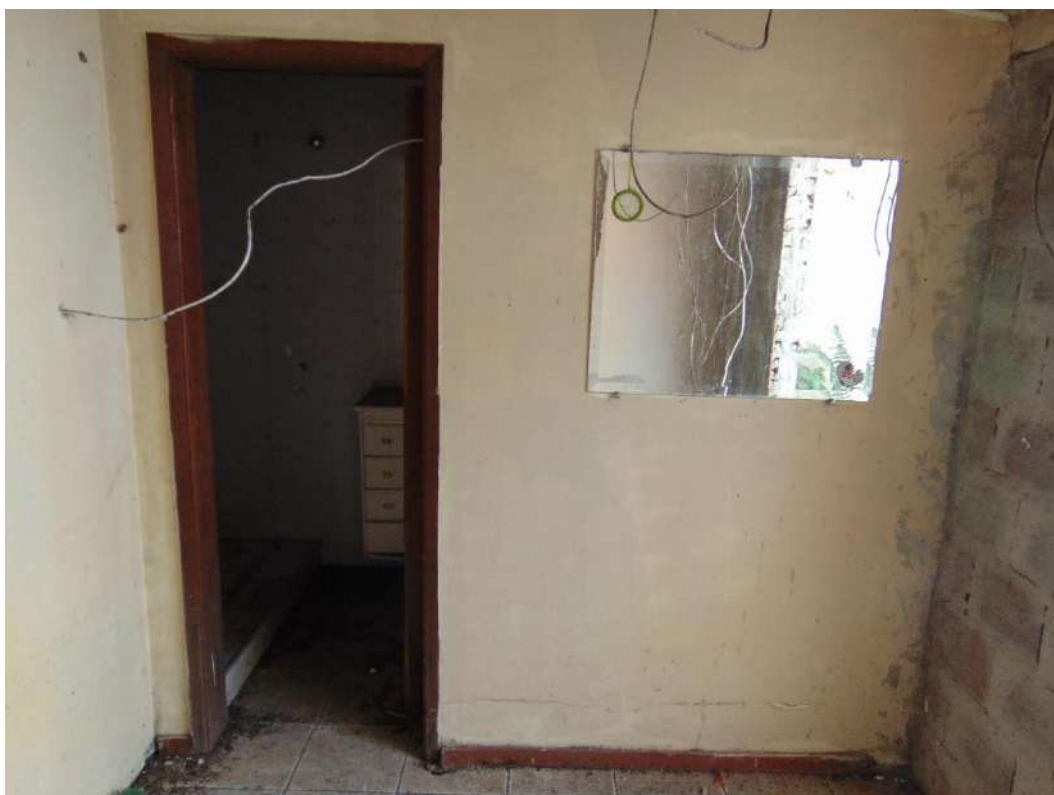
Figura 52 Acesso ao banheiro da site 3, instalações aparentes, parede inacabada e pintura com desgaste acentuado
