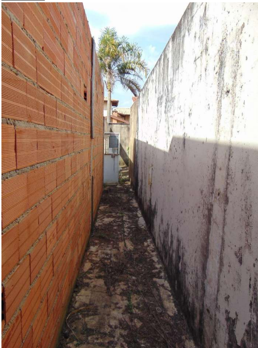
Figura 17 Corredor de acesso aos canis, pintura completamente desgastada, parede inacabada
