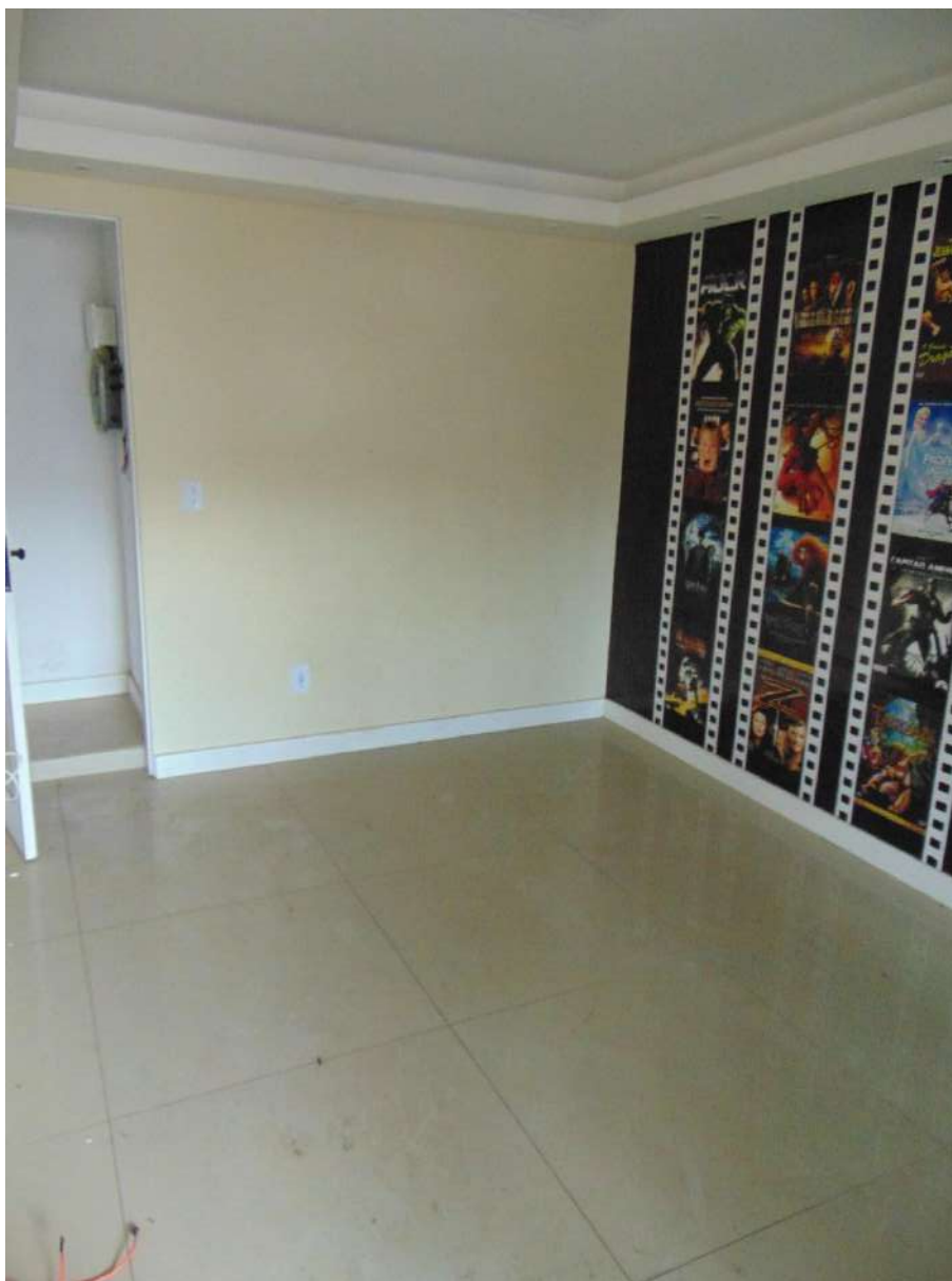
Figura 33 Identificação da Sala de Cinema, com pintura levemente desgastada.
