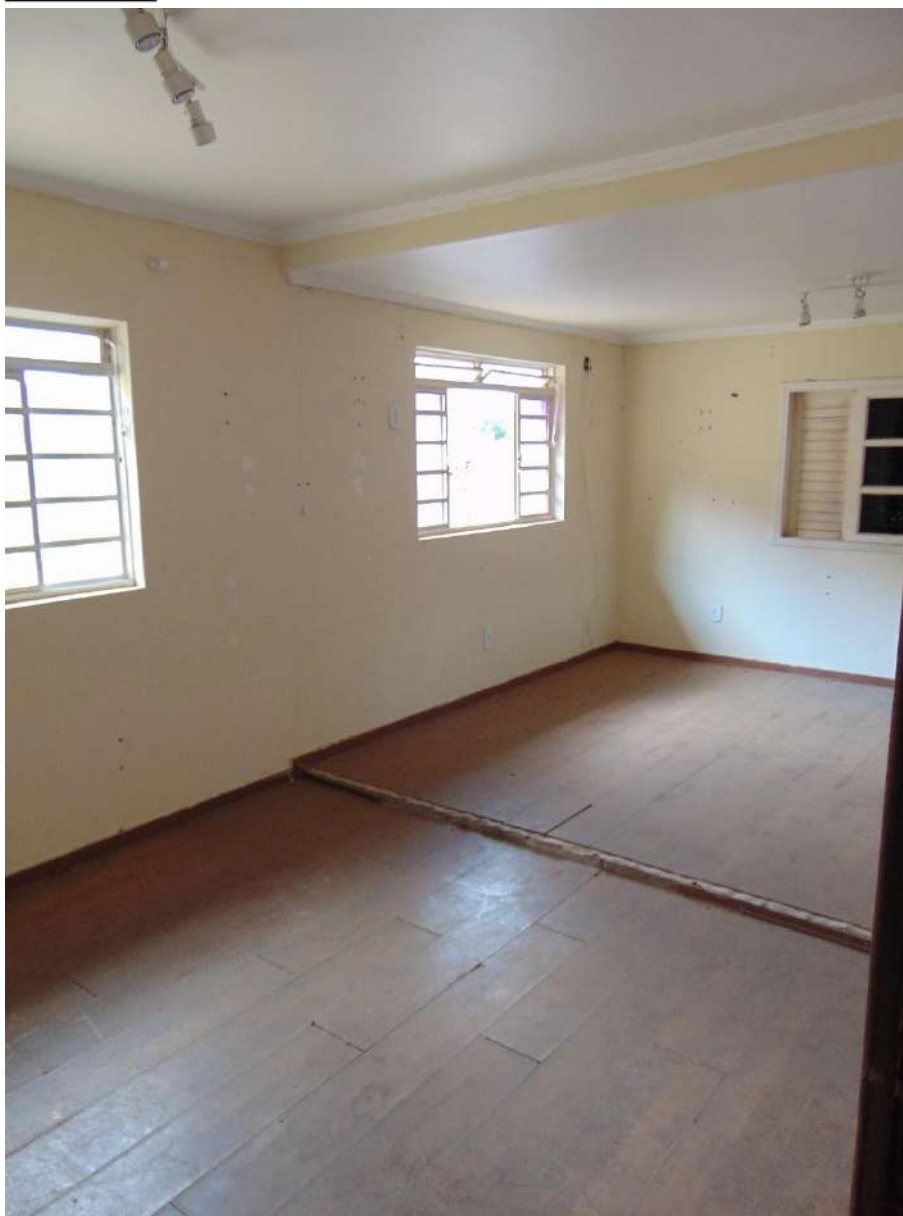
Figura 38 Suíte 1, com piso de madeira com peças empenadas, degrai inacabado e pintura no geral moderadamente desgastada
