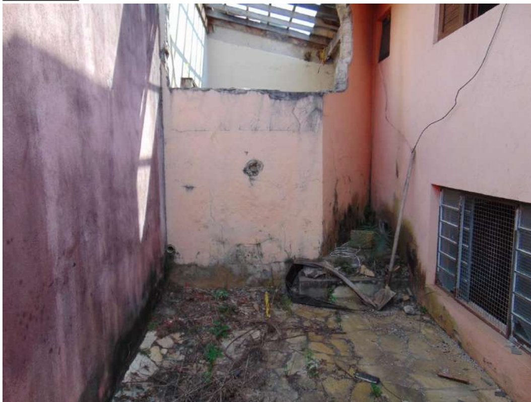
Figura 16 Corredor lateral fundos, em frente vista da varanda da suíte 3, piso e pintura completamente danificados, sinais de umidade
