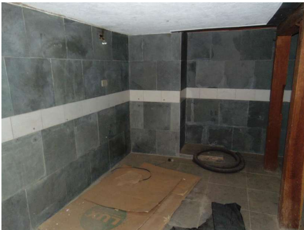
Figura 64 Identificação da sauna 2, com sinais de infiltração nos rejuntas
