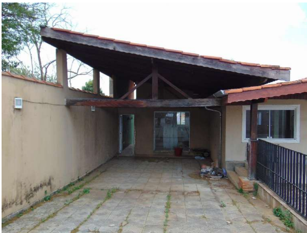
Figura 6 Identificação da garagem coberta, identifica-se infiltrações de muro, avarias na estrutura de madeira do telhado, piso danificado, características de imóvel abandonado.
