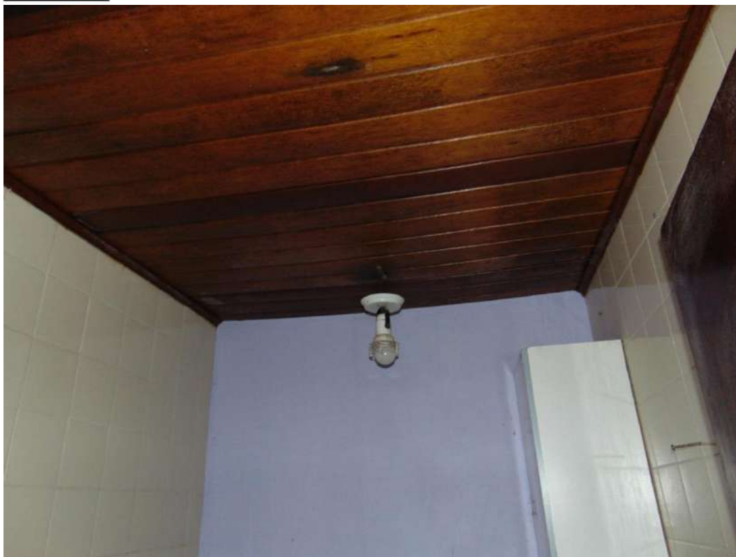
Figura 47 Detalhe de forro empenado e sianis de umidade
