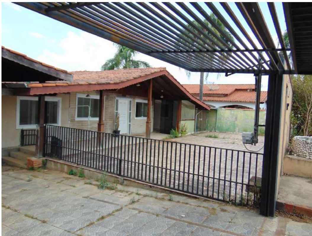
Figura 5 Fachada Interna do Imóvel, identifica-se desgaste acentuado da pintura externa, aspecto de abandono com muitas avarias.
