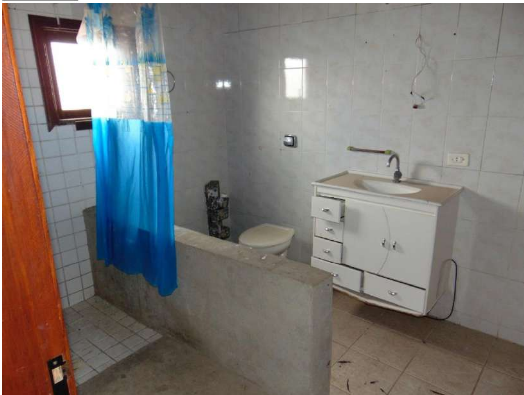
Figura 43 Banheiro da Suíte 2, com mureta inacabada, avarias no gabinete, instalações aparentes
