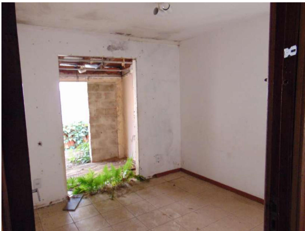
Figura 48 Identificação de suíte 3, desgaste acentuado das paredes, e identificação de pontos de umidade, vegetação saindo do piso cerâmico
