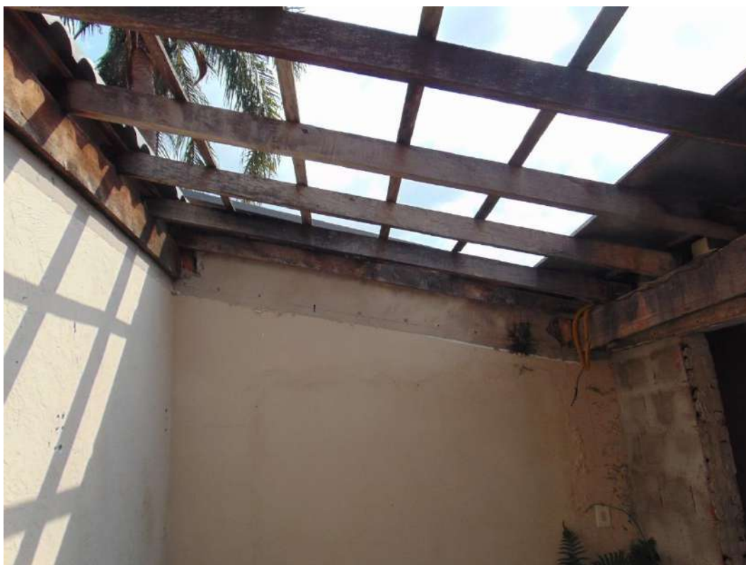
Figura 58 Detalhe de telhado ausente, parede inacabada, instalações expostas e desgaste acentuado da pintura
