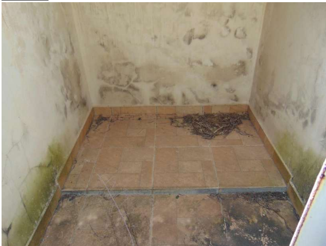
Figura 19 Detalhe Canil. com umidade na parede, pintura completamente danificada, e pontos de acúmulo de água no piso
