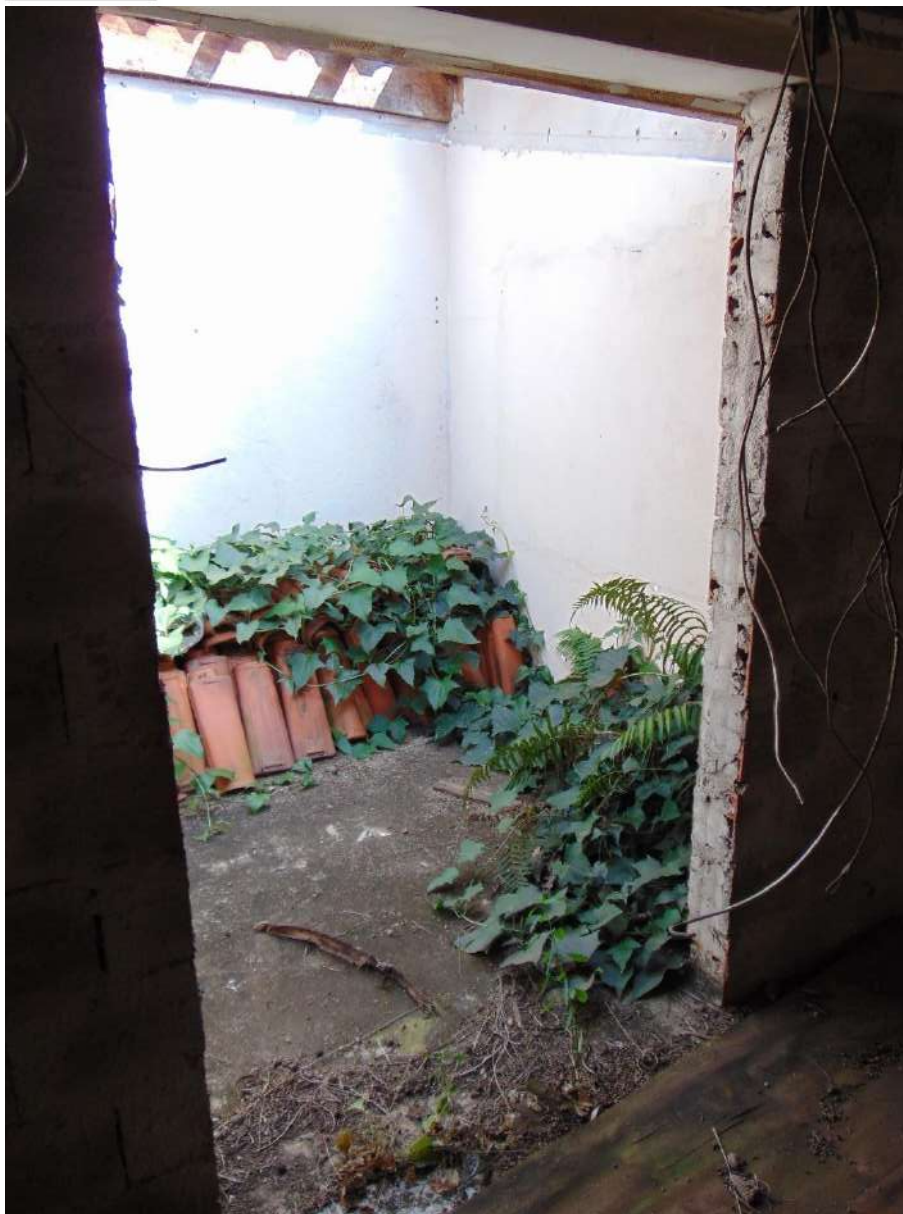
Figura 56 Acesso a varanda da suíte 3, com piso e telhado inacabados e pintura com desgaste acentuado
