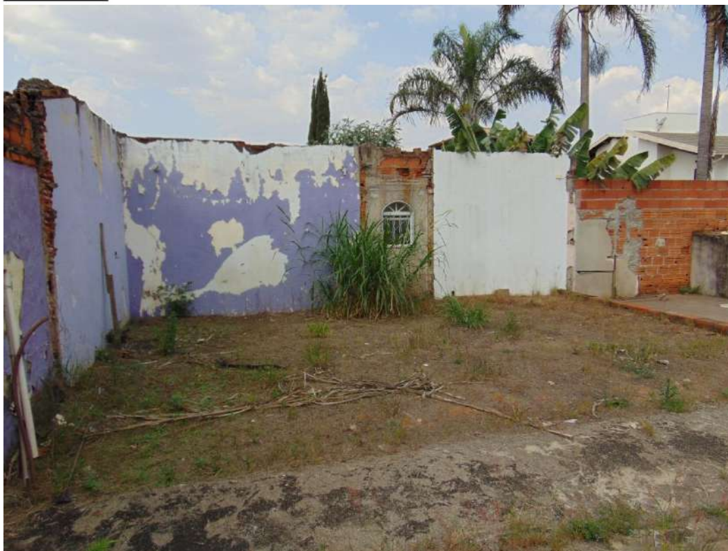
Figura 12 Identificação dos fundos, com aspecto de demolição, e pintura completamente danificada
