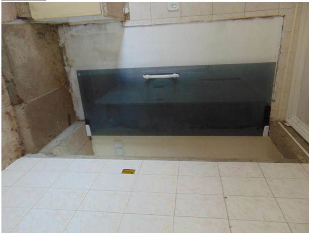
Figura 26 Porta de acesso à lareira, com ausência de azulejos
