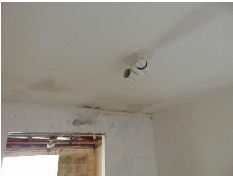
Figura 49 Detalhe de manchas de infiltração e avarias na pintura
