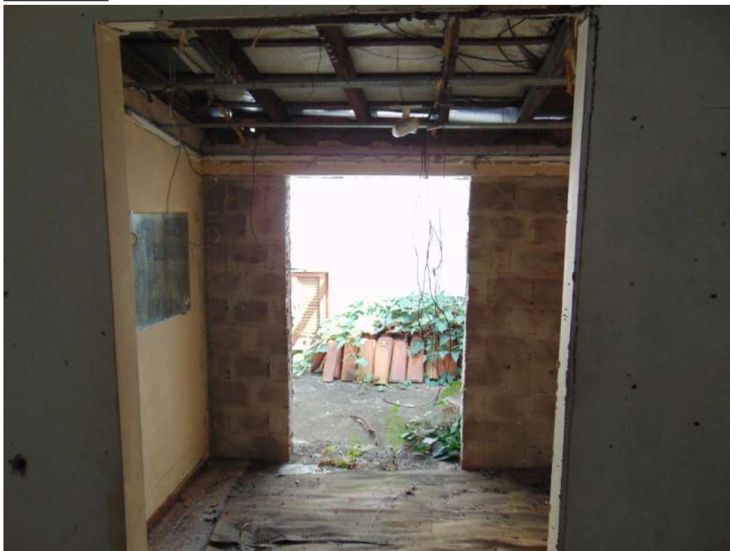
Figura 51 Closet da Suite 3, com parede inacabada, ausência de forro, e avarias acentuads na pintura e piso
